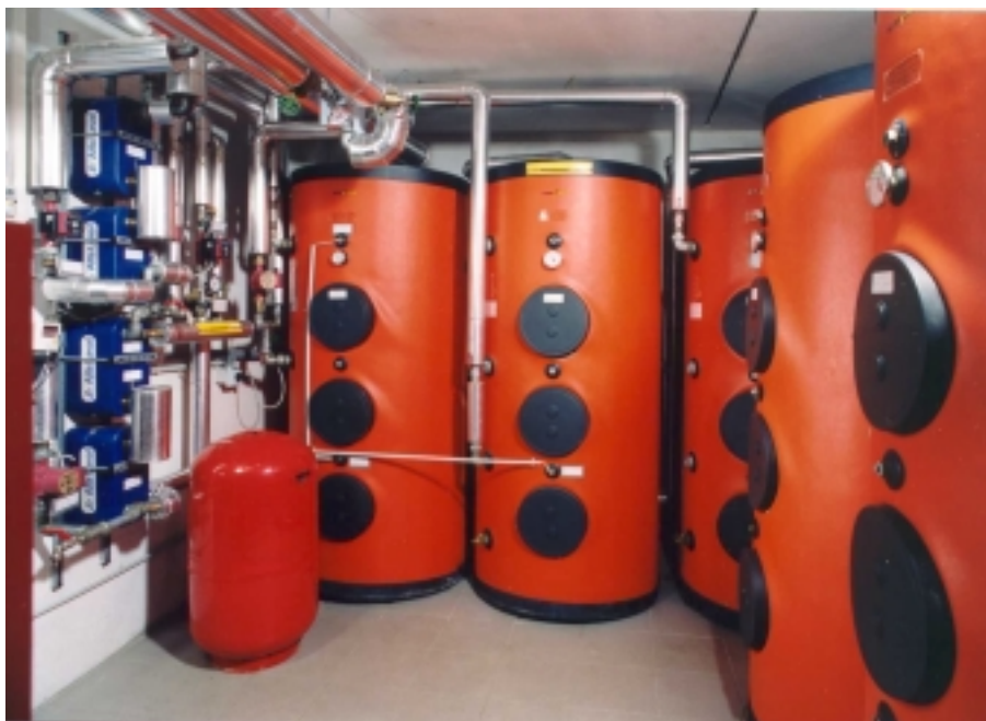
Abbildung 41: In der Anlage Heinrichstrasse erfolgt die Energiespeicherung über ein trinkwassergeführtes Mehr-Speicherkonzept - 6 x 1000 l (Bildquelle: Steirische Ferngas)
