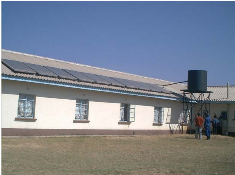
Abbildung 4: Eine der Anlagen, die an der St. Johnes Secondary School errichtet wurden. Die thermosyphonisch betriebenen Anlagen haben 20\text{ m}^2 Kollektorfläche und einen 1200 Liter fassenden Warmwasserspeicher.
