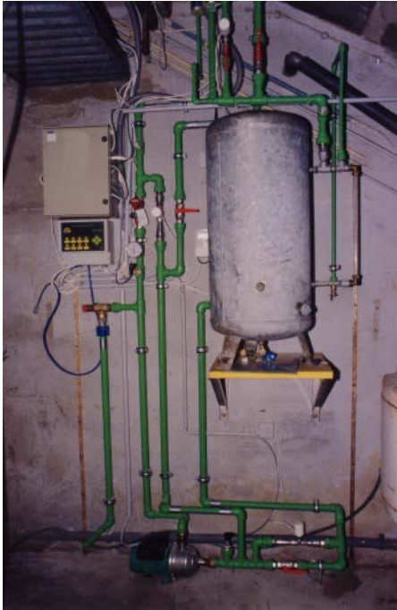
Abbildung 10: Die Hydraulik – Einbindung in das Schwimmbad, das Rücklaufgefäß, Pumpen, Regelung und Messdatenerfassung wurden im Technikraum des Schwimmbades montiert.
