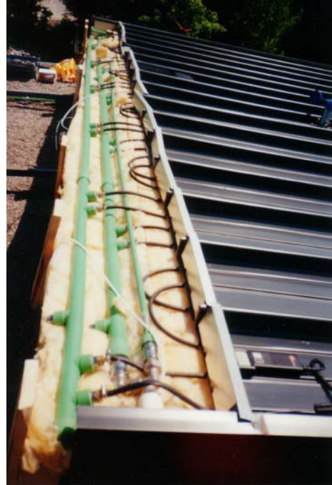
Abbildung 8: Nach der Montage der Schläuche erfolgte die Anbindung der Sammler (Vor- und Rücklauf). Die Sammler wurden etwas schräg gestellt, sodass die Anschlussstutzen der Schläuche auch vollständig entleert werden.
