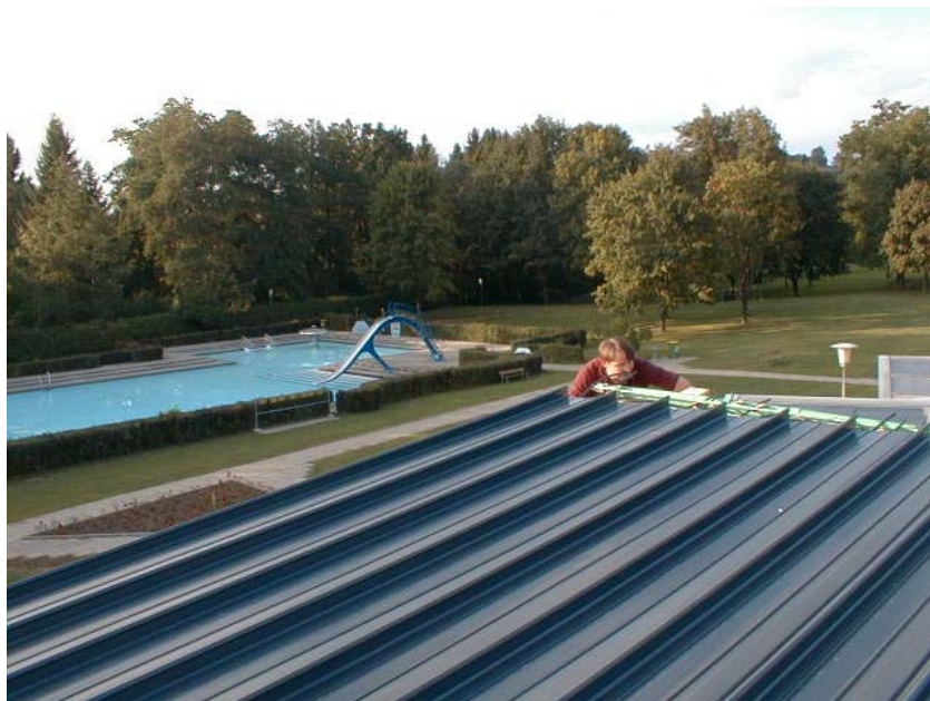
Abbildung 3: Testkollektor auf dem Betriebsgebäude des Gleisdorfer Freibades
