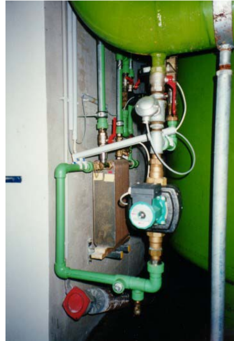
Abbildung 11: Die Abbildung zeigt die Einbindung des Solarkreises in den Schwimmbadkreis. Es besteht die Möglichkeit einer Systemtrennung mittels Plattenwärmetauscher.
