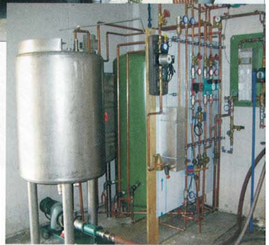
Installation bei der Brauerei Neuwirth
