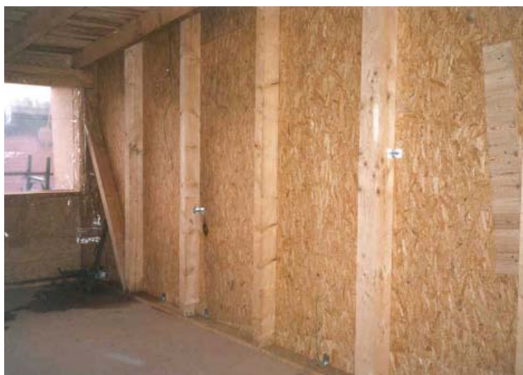
Abbildung 1.7: Innenansicht der Südfassade. Befestigung der Kollektorrückwand (OSB-Platte) an den Holzriegeln der Wandkonstruktion mit Stahlwinkeln
