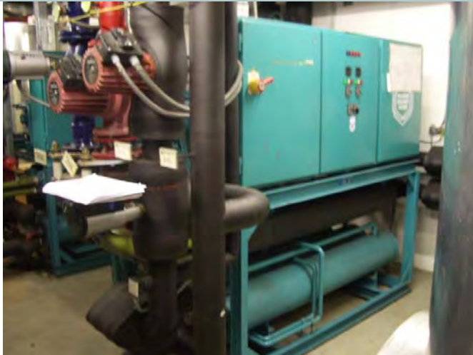
Kältemaschine Bestand 2 x 174 kW
