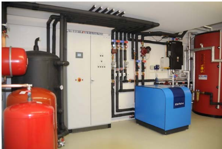
Abb. 1 – Solarthermische Kühlanlage Magistratsabteilung 34, Wien
