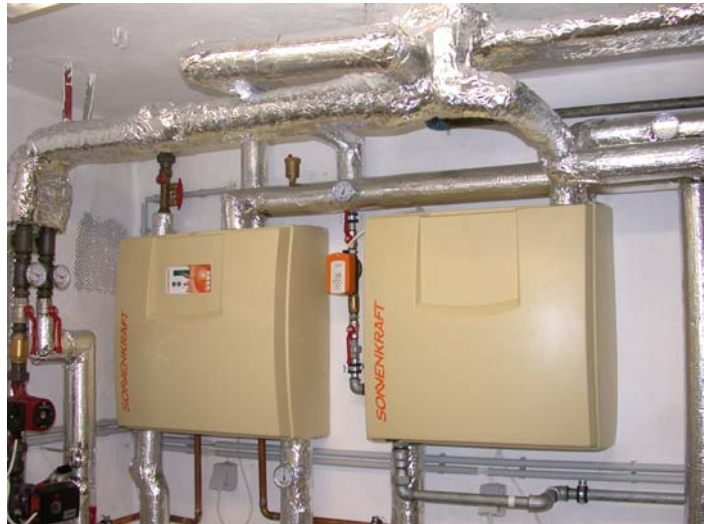
Abbildung 4: Vorgefertigte Module für die Einbringung der Solarenergie in den Energiespeicher (links) und eine externe Brauchwasserbereitung im Durchlaufprinzip (rechts). (Bildquelle: AEE INTEC)
